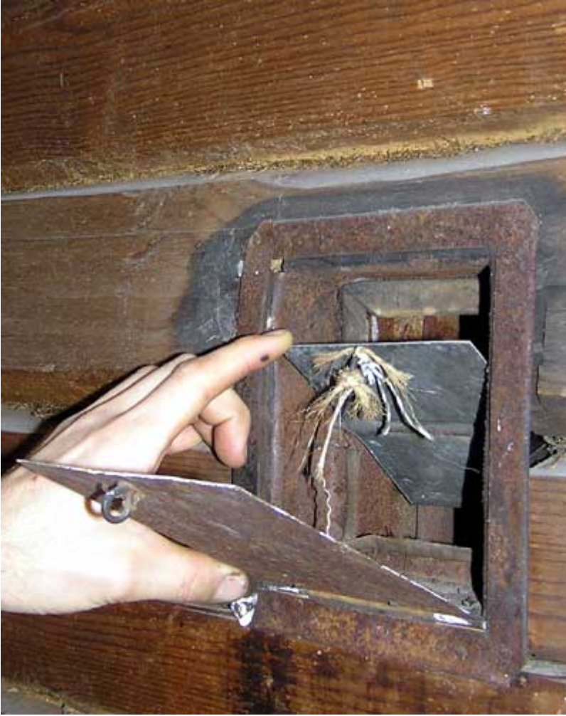
Ilmaventtiili vanhassa kylmähuoneessa.
